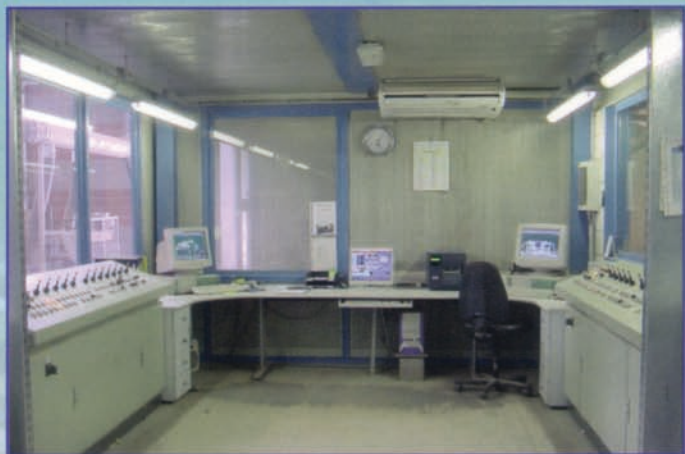
Cabina comando impianto con supervisione tramite Personal Computer e PLC.
