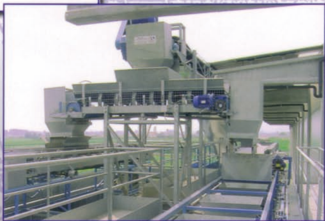
Sistema di nastri per distribuzione inerti nelle varie tramogge di stoccaggio.
